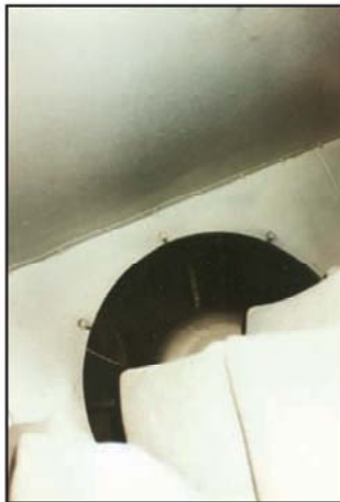
Clean Exhaust Fan
